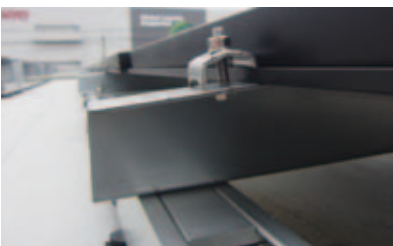
太陽光パネル固定部分
