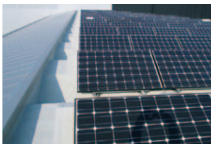
意匠性に配慮する、パラベットを超えないモジュール設置。
