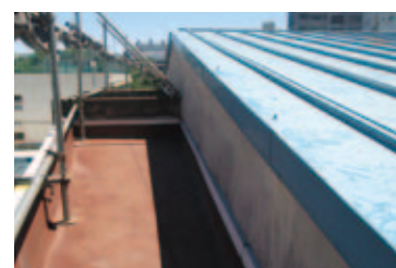
改修前:ケラバ部
