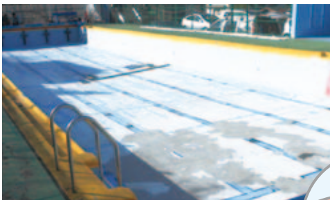
某プールでのハガレの状況。
