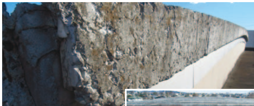
改修前は、側面部分の劣化が進んでいました。
