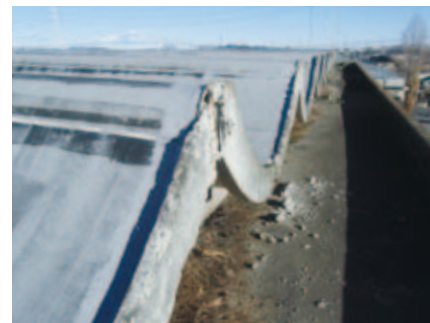
改修前の側溝部分。剥離したコンクリート片が散見されました。
