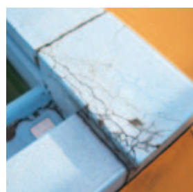
経年劣化によるひび割れ。
