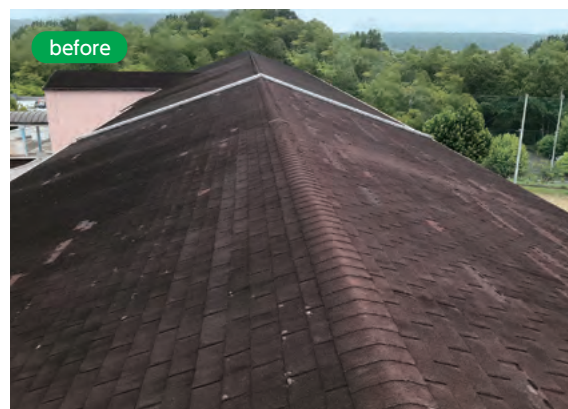
防水改修前の様子。既存はアスファルトシングル下地で経年劣化が目立っていました。
