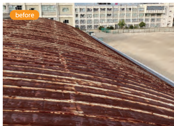
錆びが進行した既存瓦棒屋根。
