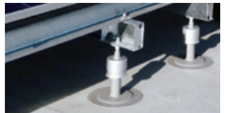
本事例におけるグリッドベースMの設置部。
