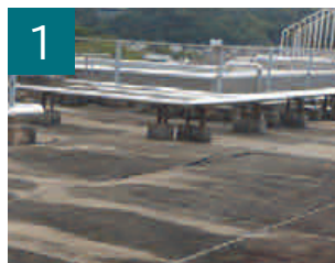
1 保護コンクリートどうしが伸びることで押しあい、突き上げるようにして隆起しているのがわかります。
