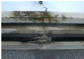
改修前： パラペットのクラックがあご裏まで達し、 防水層まで繋がっています。
