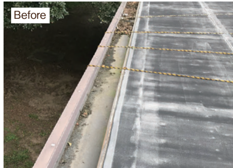
損傷した軒樋。
