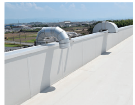
バラベツ上部のダクト
