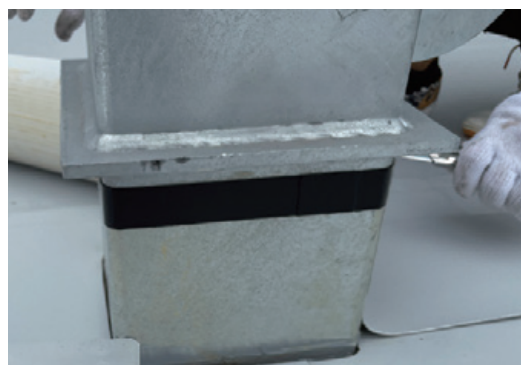
硬質塩ビ板、FL鋼板を用いて基礎部周辺に増し貼り層を構築。
